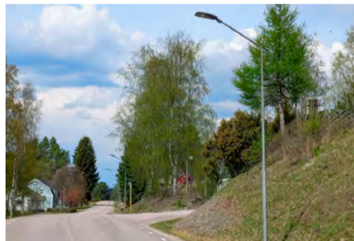
En stor del av armaturerna på sträckan Bergsäng - Byn - Hornnäs har bytts ut. Från Hornnäs till Stackarud återstår fortfarande en del.
